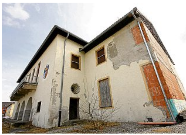
„Jeder Architekt hat abgewunken“: Eine Sanierung des ehemaligen Kasernenkinos würde sich nicht rechnen. Nun soll es abgerissen werden. FOTO: ARP/ARCHIV
